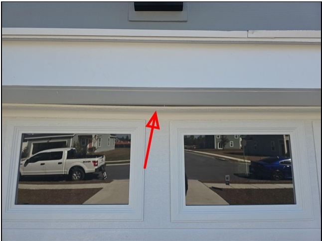
loose garage door seal
