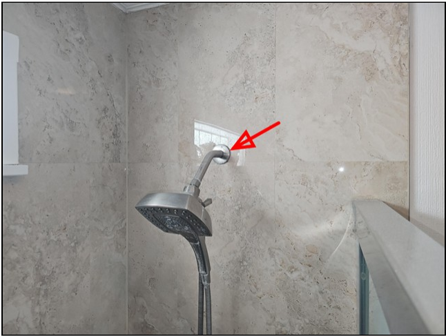
loose showerhead stem
